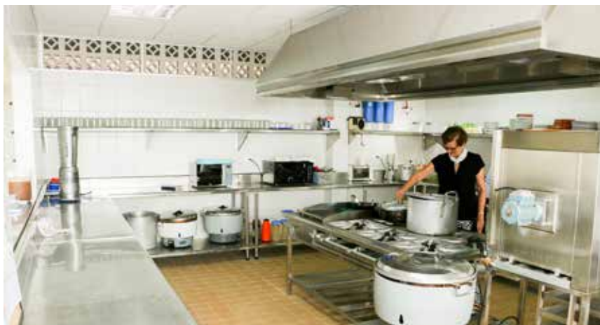
» Nueva cocina industrial, con implementos en acero inoxidable
